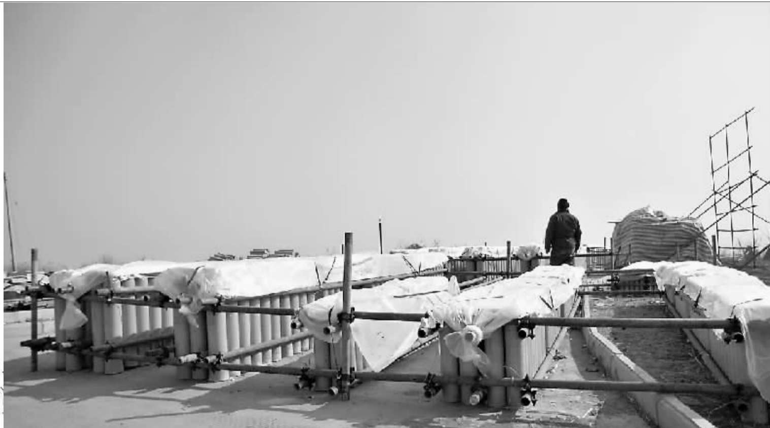
鹤山区烟火燃放点设备已安装完毕。
