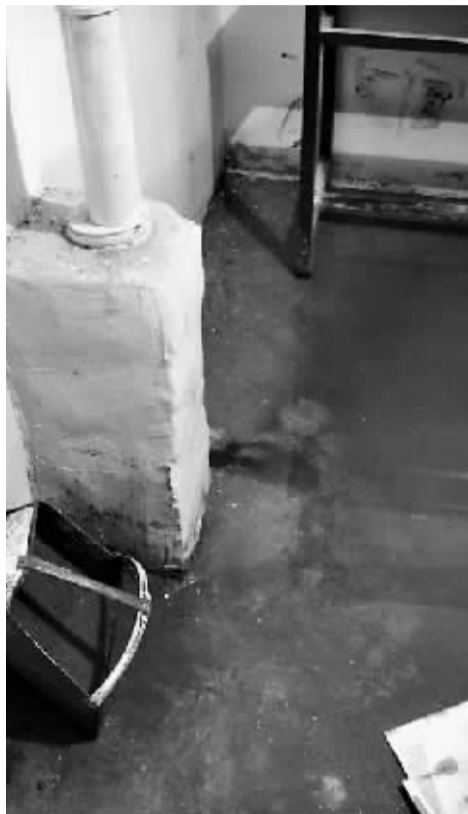
地下室的污水。晨报记者 王帅 摄
