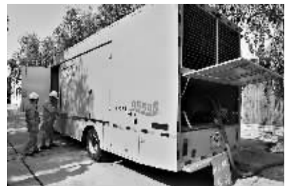
市供电公司的高考准备的应急发电车。晨报记者 赵永强 摄
