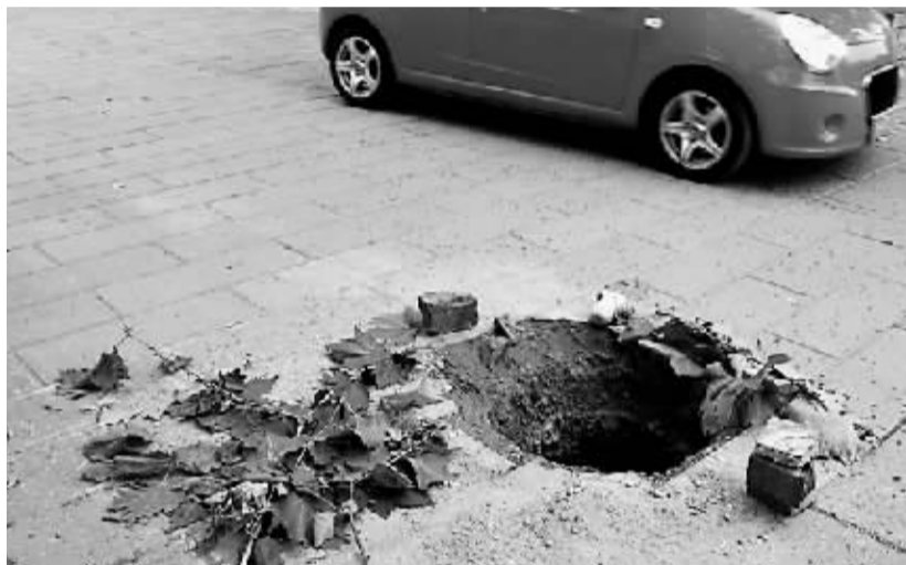
已经有好几辆车被这个无盖窨井“坑”了。
