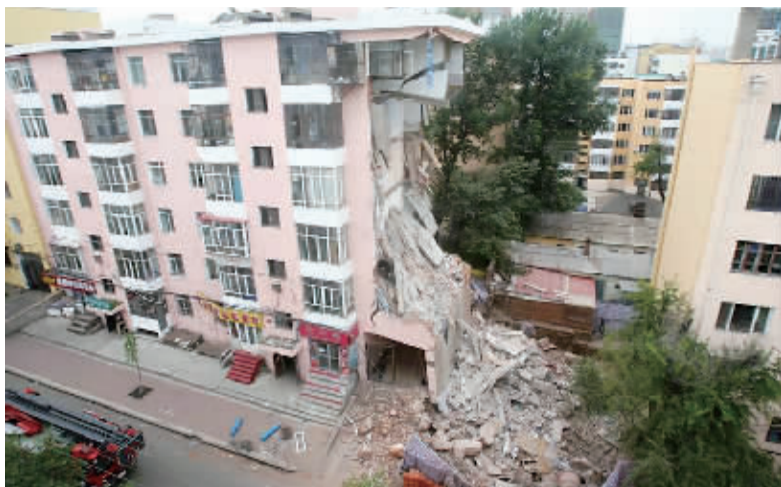
发生垮塌的居民楼
