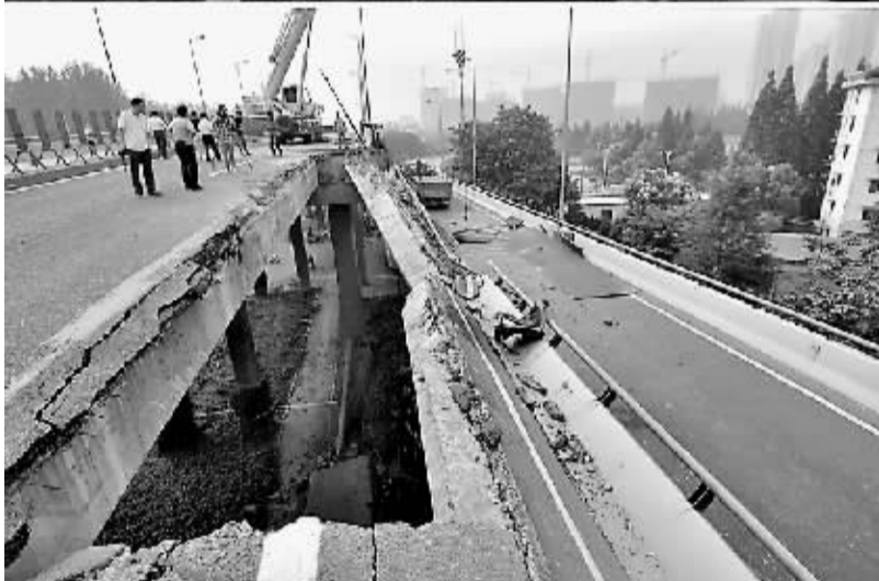
7月23日,建成已74年的钱塘江大桥依然“坚强”(上图),而建成不过14年的钱江三桥却塌了,成了“桥脆脆”(下图)。
