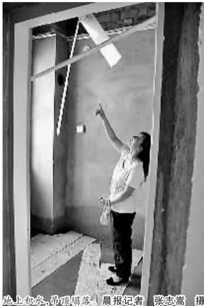
地上积水，吊顶塌落。晨报记者 张志嵩 摄
