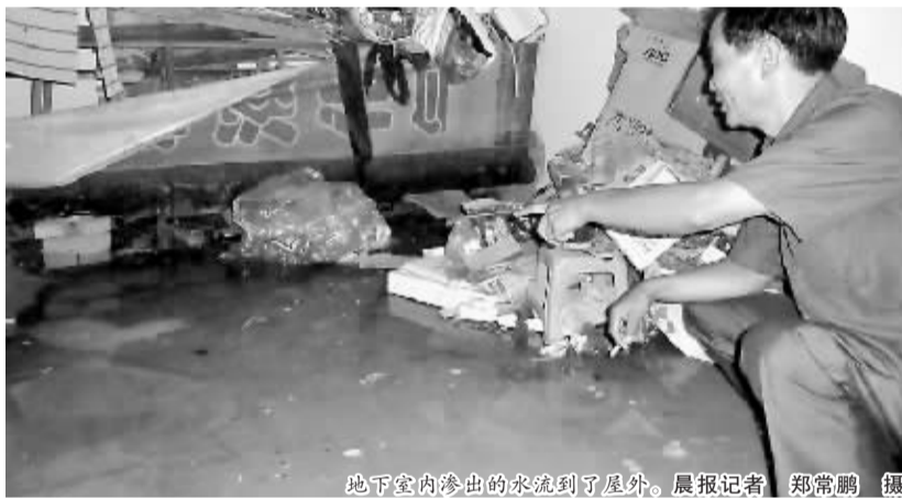
地下室内渗出的水流到了屋外。晨报记者 郑常鹏 摄
