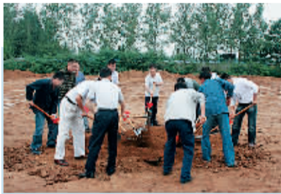
鹤壁市顺达尔福特 4S 店项目开工奠基现场。晨报记者 许燕琴 摄
