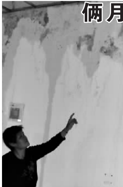
姜女士家的门面房修过后仍在漏雨。
