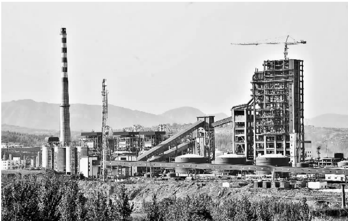
位于宝山循环经济产业集聚区的年产60万吨甲醇项目,占地1000余亩,总投资约35亿元。晨报记者 赵永强 摄
