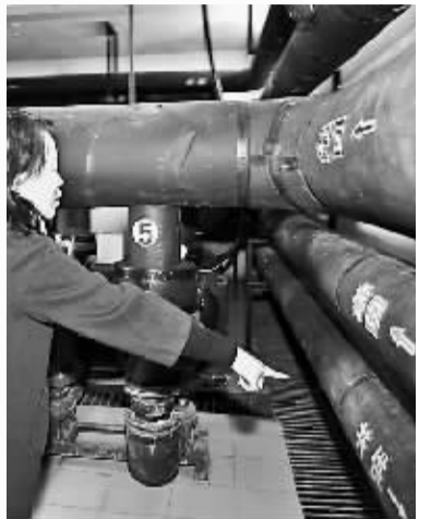
在新区淇水百合小区,工作人员向记者介绍地源热泵设施运行情况。
