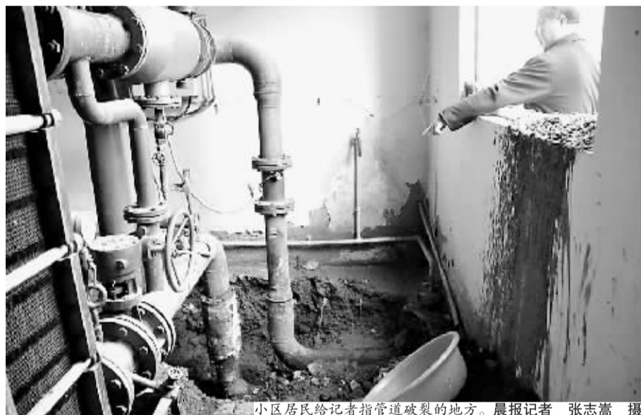
小区居民给记者指管道破裂的地方。晨报记者 张志嵩 摄
