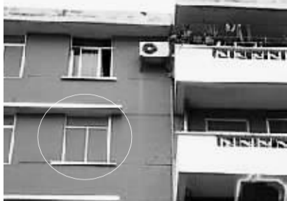
“神楼画窗”细看破绽明显,可见东墙顶楼仍有一户是真窗户。
