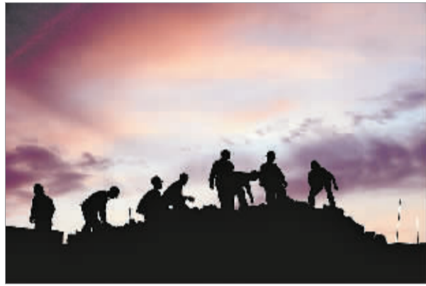
工人伴着落日的余晖在兰新铁路工地上施工(10月1日摄)。兰新铁路第二双线是我国一次性开工里程最长的铁路客运专线,也是我国西部最长的高标准铁路建设项目。 何俊昌 摄
