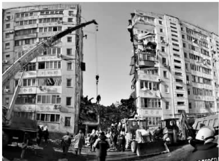
煤气爆炸后楼体倒塌。
