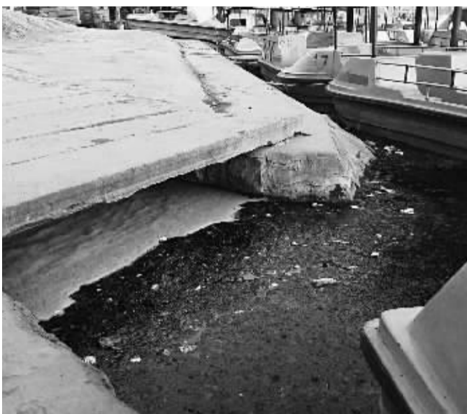
▲暗渠排污口附近水面上到处是垃圾。晨报见习记者 贾正威 摄
