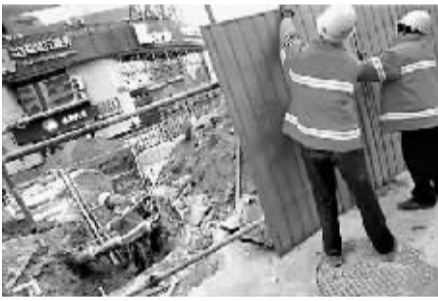
▲工作人员正在对发生事故的地带安围挡。
