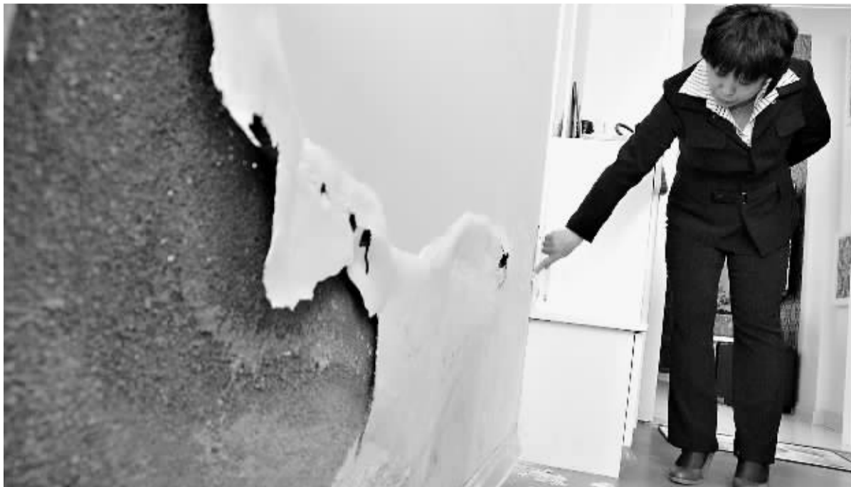
李女士家新居墙皮脱落情况严重。晨报记者 张志嵩 摄
