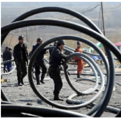
5月3日,参与救援的矿工正在运送排水管线。 新华社记者 王松 摄
