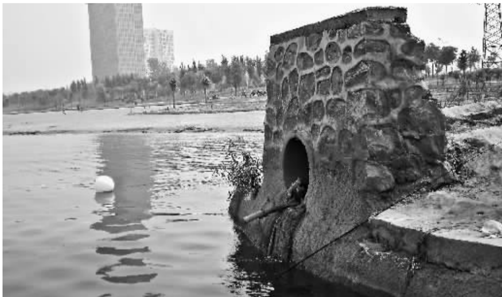
金沙滩南侧的一处排污口。
