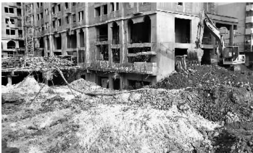
7月27日,暴露于地面上的天然气管道。晨报记者 郭坤 摄
