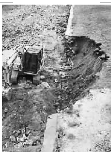
部分河堤坍塌。
