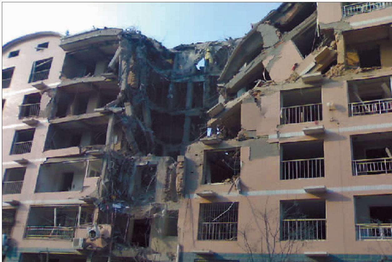
▲ 发生爆炸的居民楼部分已坍塌。
