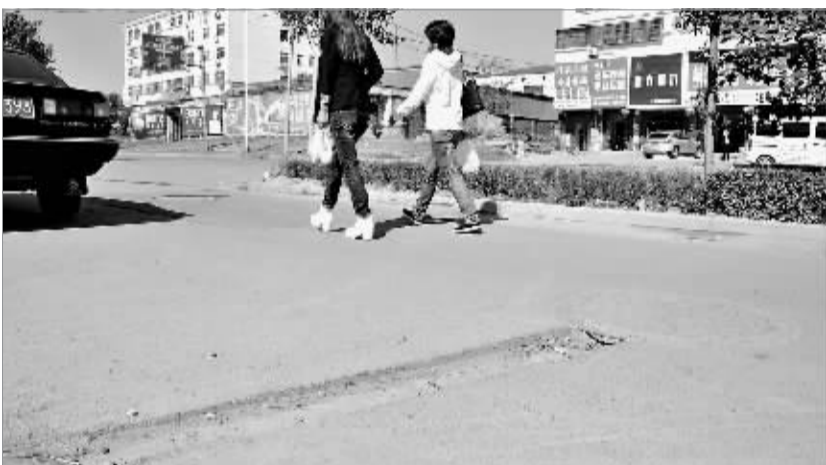
10月18日,在与太行路交叉口附近的黄河路,南侧的非机动车道上被切割出一个深约5厘米的凹槽通向窨井,据附近居民反映是附近的商户用来排水的。这个凹槽横在非机动车道上,占了整个路面宽度的一半,路过的市民纷纷绕行。 晨报记者 张志嵩 摄
