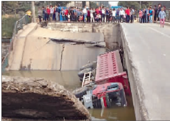
江苏丹阳一大桥坍塌
