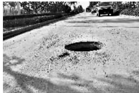
没盖的窨井。晨报见习记者 常凯 摄
