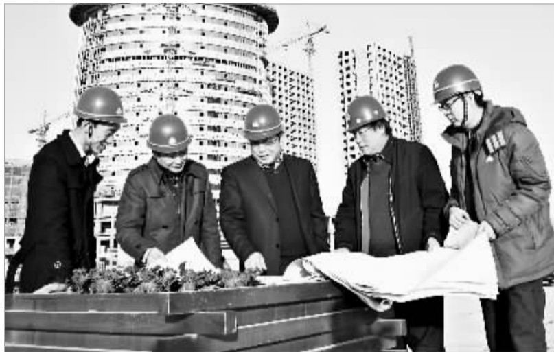
吴保印与党员和技术人员讨论大厦外围施工方案。鹤壁日报记者 车国胜 摄
