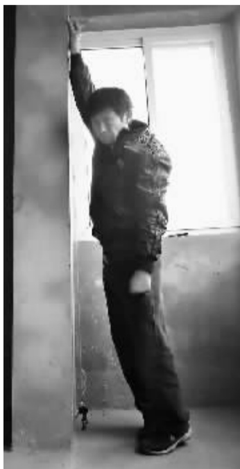
▲张先生自制工具进行测量,明显能看出墙体倾斜。
