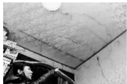
一居民指着楼上住户漏水下渗的印记。
