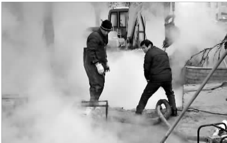
供热主管道破裂,工作人员正在抢修。晨报记者 席适之 摄
