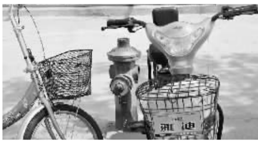
新区黄河路中段的破损消防栓
